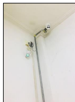
粒籽源暂存室监控及报警器
